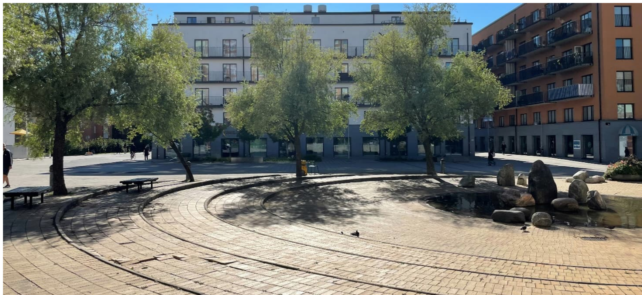
Figur 22: Skador och ojämnheter inom plattsatta ytor Poseidons torg. Foto taget vid platsbesök 2024-09-26
