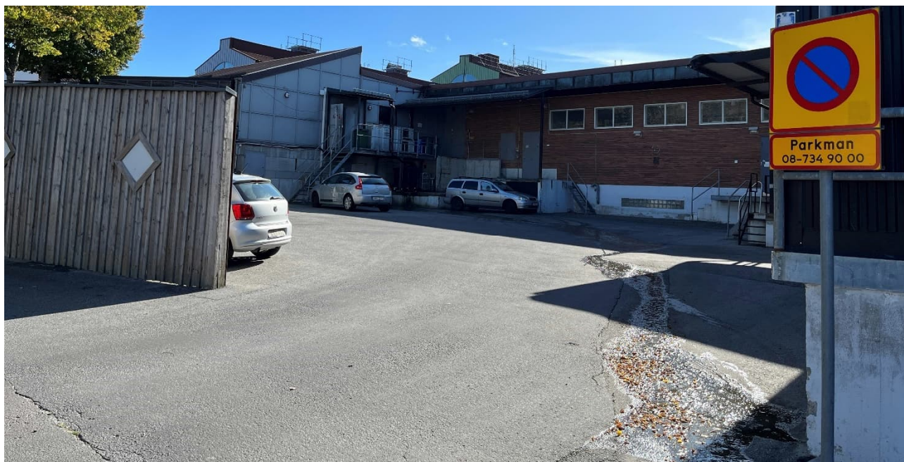
Figur 23: Skador och ojämnheter inom asfalterade ytor lastintag norra sidan av centrum. Foto taget vid platsbesök 2024-09-26
